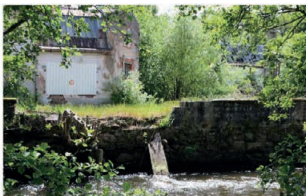
Erosion de la berge par la Vologne et risque de pollution
